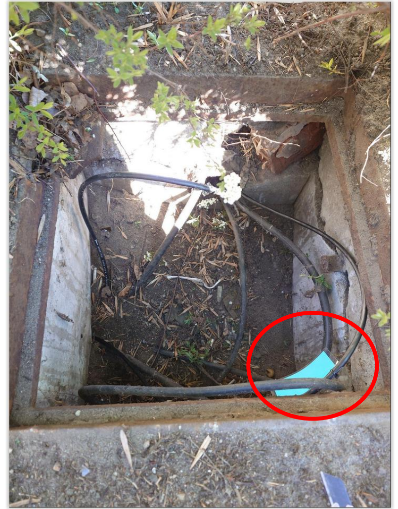
Stan wnętrza studni po instalacji kabla. Przywieszka identyfikacyjna jest odwrócona. Niemożliwa jest identyfikacja kabla. Fotografia niepoprawna.
