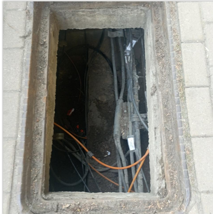
Prace polegały na wykonaniu napraw w mufie. Stan przed pracą – mufa niewidoczna, fotografia niepoprawna.
